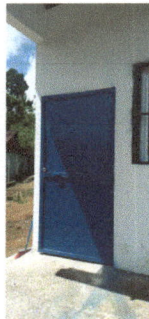
Foto 5: Fotografía de puerta que fue sustituida.
